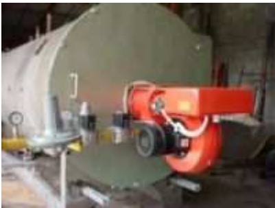
GENERADORES DE VAPOR. (CALDERAS)
