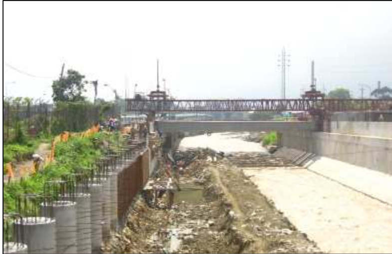
Obra del puente de pérgolas y protección en construcción de la ribera del río en el costado occidental.
