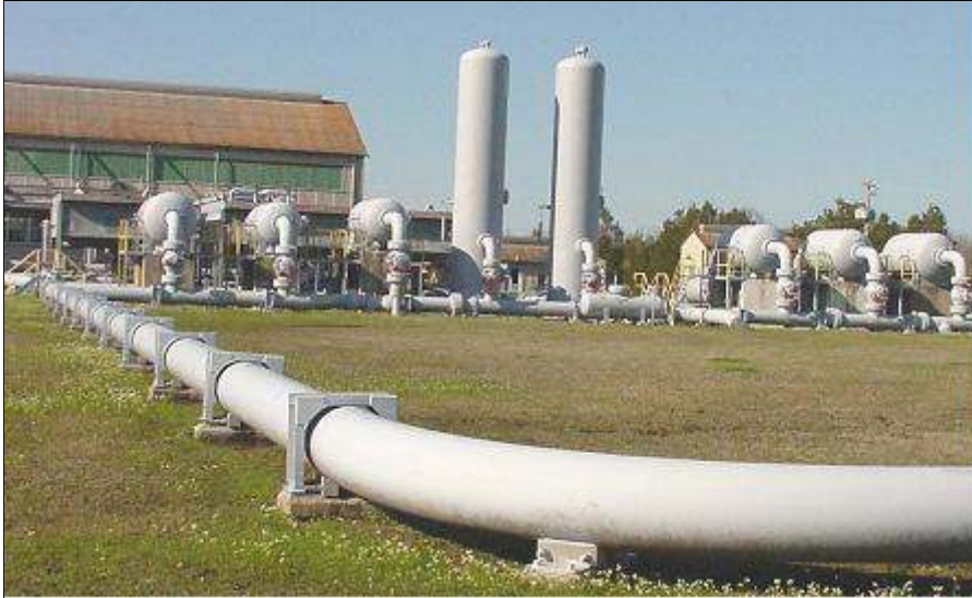
Imagen 2: Gasoducto en USA ingresando a la planta de compresión Gallion en Alabama
