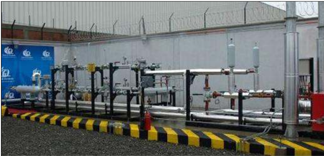
Imagen 6: Estación de descompresión de GASES DE OCCIDENTE S.A. E.S.P.
